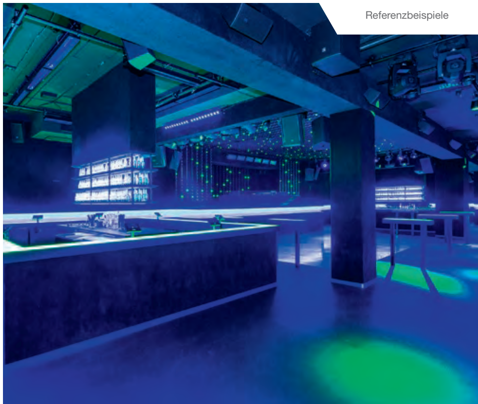
Hochmodernes Design trifft auf hochintelligente Anlagentechnik. Ein Club, der sowohl Partyfreunde als auch Technikliebhaber begeistert.
