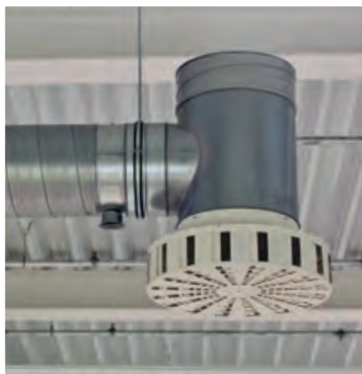
Luftaustausch und die Frischluftversorgung sind jederzeit sichergestellt.
