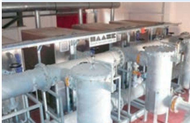
Рисунок 9.5 Газодобывающая установка на шахте «Стилингфлит»
