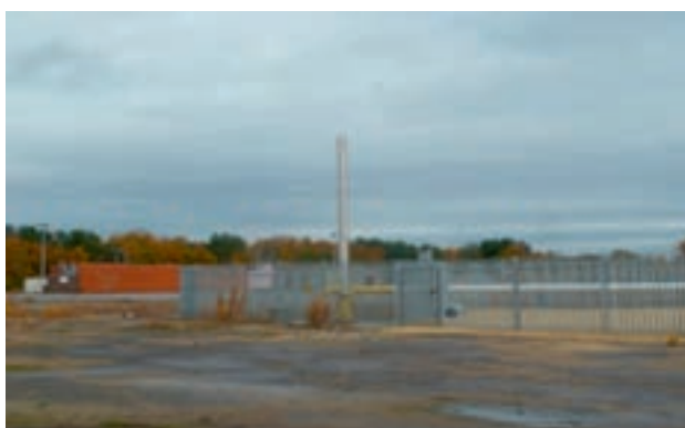
Рисунок 9.4 Газоотвод на шахте «Стиллингфлит»
