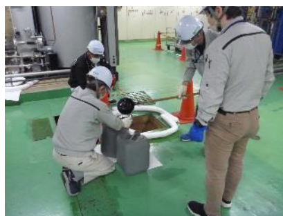
<地下タンク（重油漏洩）>
