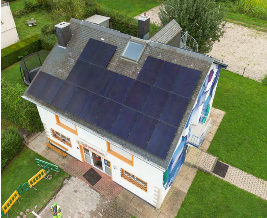
Jugendhaus Woodstock Fotovoltaikanlage Installations solaires photovoltaïques Solar photovoltaic system
