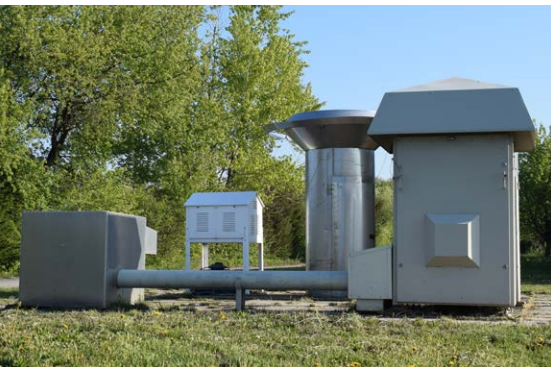
Sammelstation für Luftstaub
