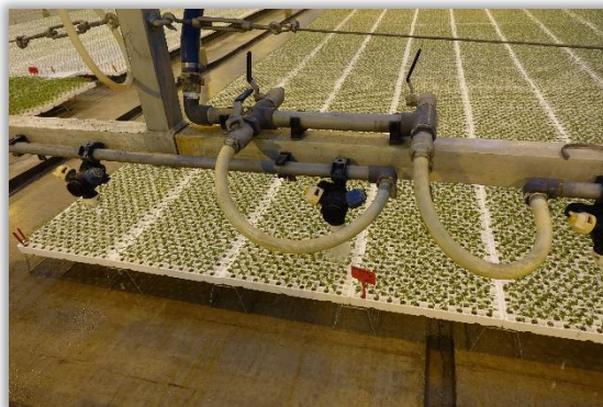
Rys. 49. Przewody cieczowe „zagrożone” samoopryskiem.
