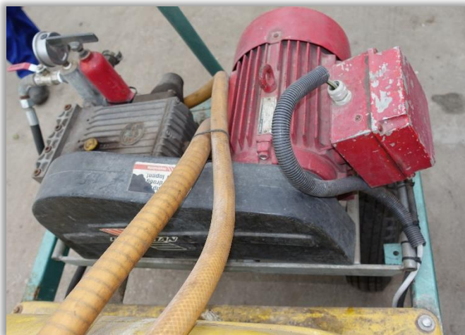
Rys. 21. Osłona napędu pompy - napęd od silnika elektrycznego.
