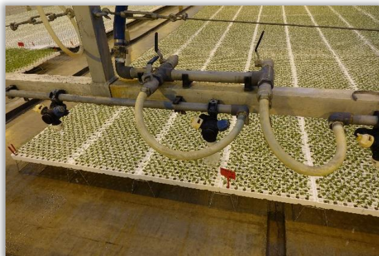
Rys. 58. Przewody cieczowe „zagrożone” samoopryskiem.
