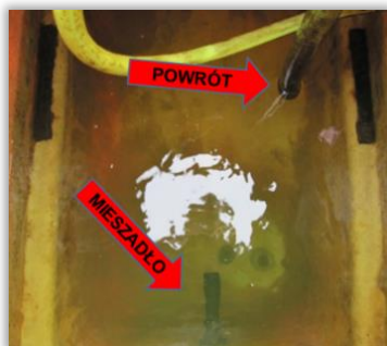
Rys. 33. Mieszadło hydrauliczne i przewód powrotny do zbiornika.
