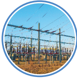
Distributeurs d'eau et d'énergie
