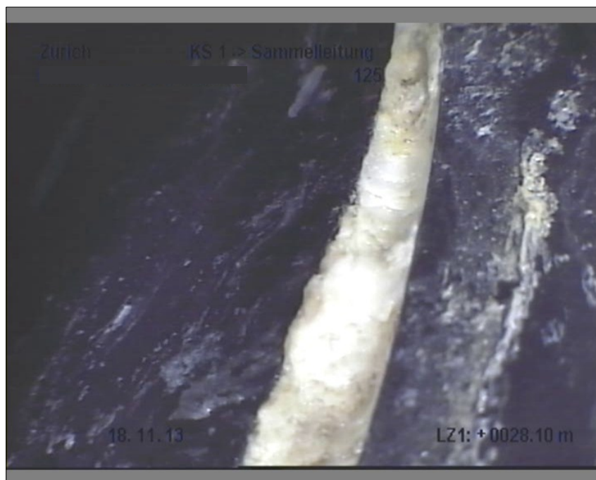
Foto: 1_11A, Datenträger Nr: 181113_1, 00:07:08 28.1m, Infiltration, Schwitzen / Verkalkung, an einer Rohrverbindung, von 2 bis 10 Uhr
