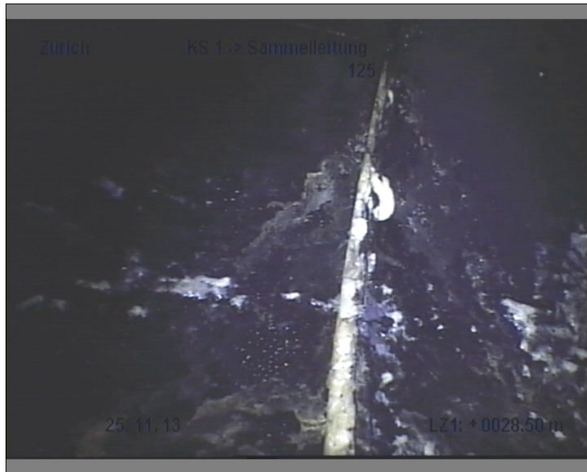
Foto: 1_12B, Datenträger Nr: 181113_1 28.12m, Reparatur mit grabenlosem Verfahren , von 12 bis 12 Uhr / HESAN
