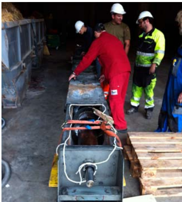
Förderschnecke unter E-Filter der OL 4
