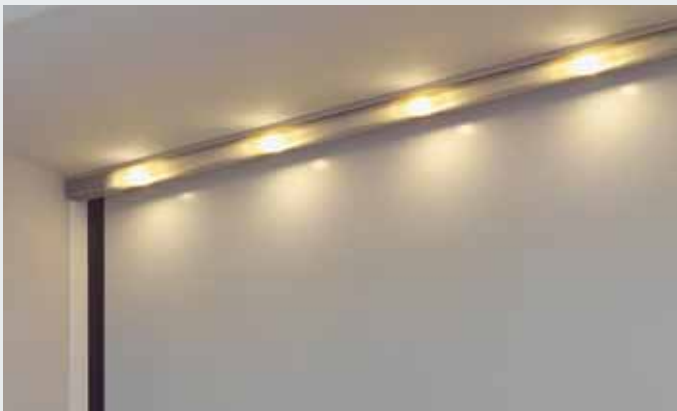
Barre d'éclairage à LED montée sur le linteau
